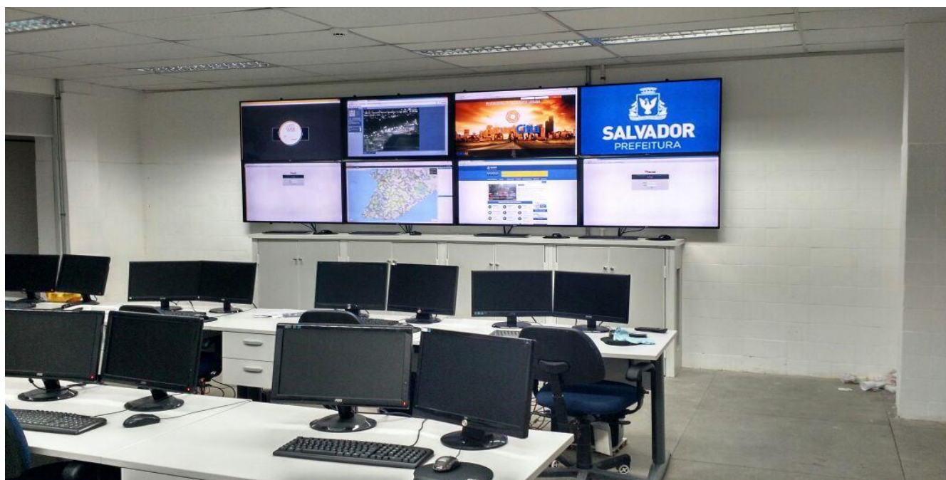
CCO - Centro de Controle Operacional da SEMOB.
