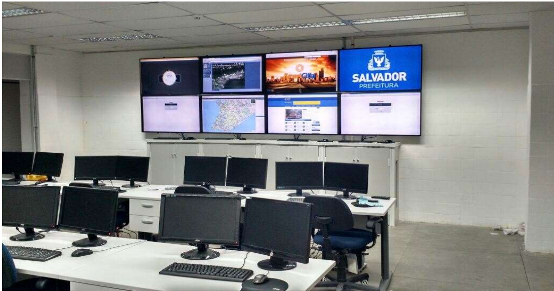
CCO - Centro de Controle Operacional da SEMOB.
